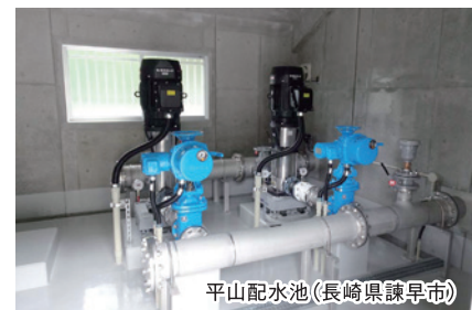
平山配水池(長崎県諫早市)
