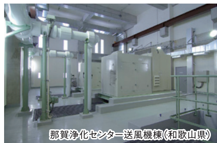
那賀浄化センター送風機棟(和歌山県)
